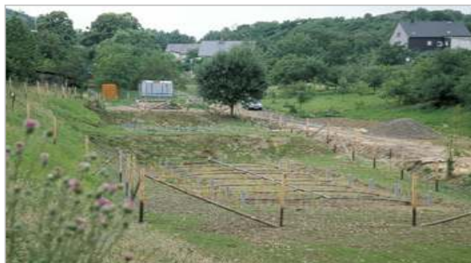
Pflanzenkläranlage kurz vor Inbetriebnahme, Juli 2000
